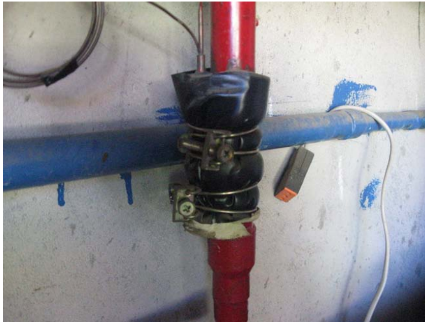
Detalle del termistor de la válvula de mezcla.
