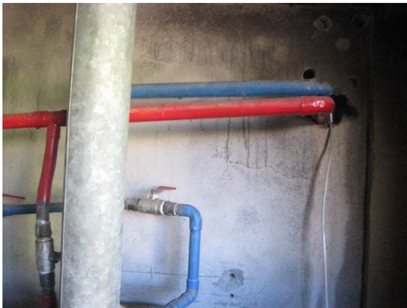
Detalle con no existencia de aislación en las tuberías de ACS.
