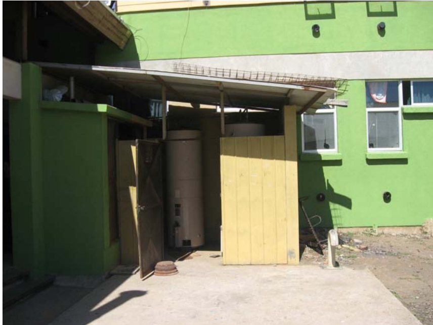
Detalle de la sala de calefacción con deficiencias en la aislación.
