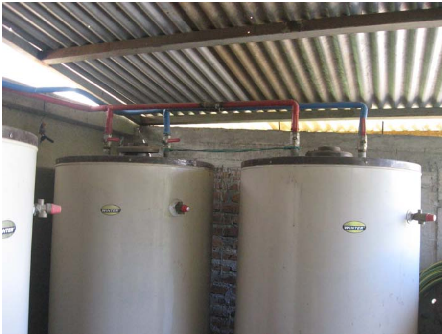
Detalle de los acumuladores de ACS.
